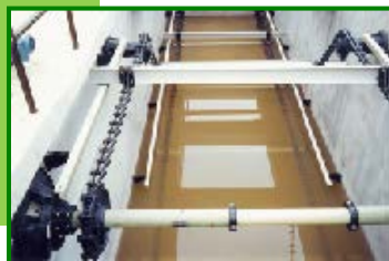
เครื่องกวาดตะกอน (Clarifier)
